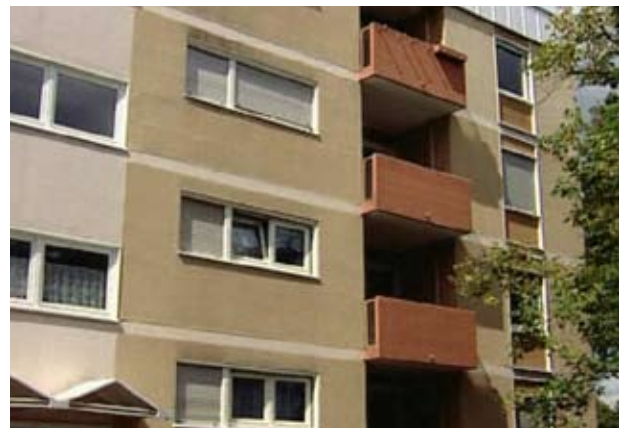
Das Problem: es fehlt meist jegliche Wärmedämmung
